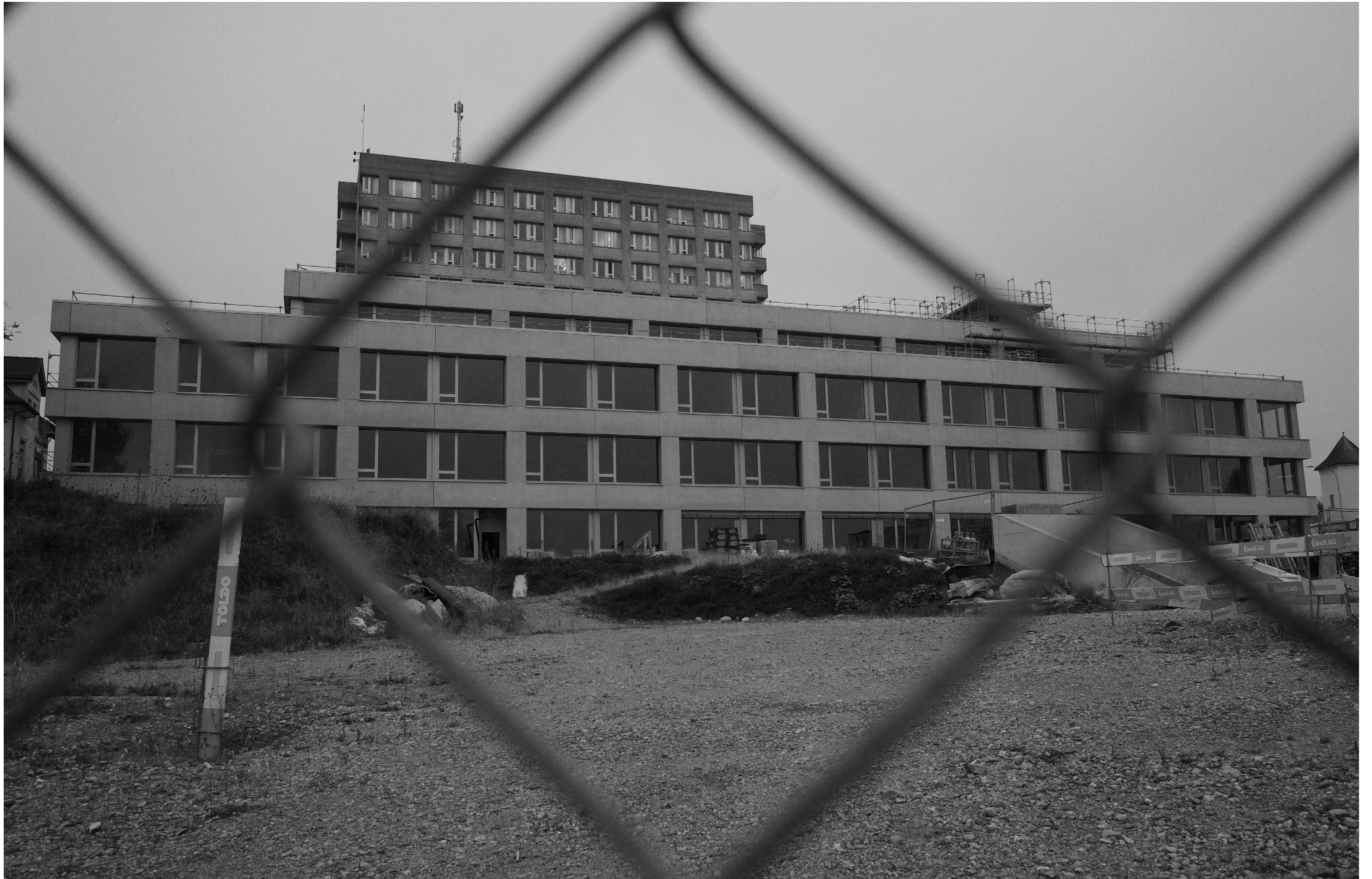
Abb. 6: Baustopp GZO Wetzikon, Eigene Darstellung
